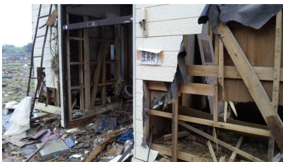
陸前高田・倒壊した家屋
